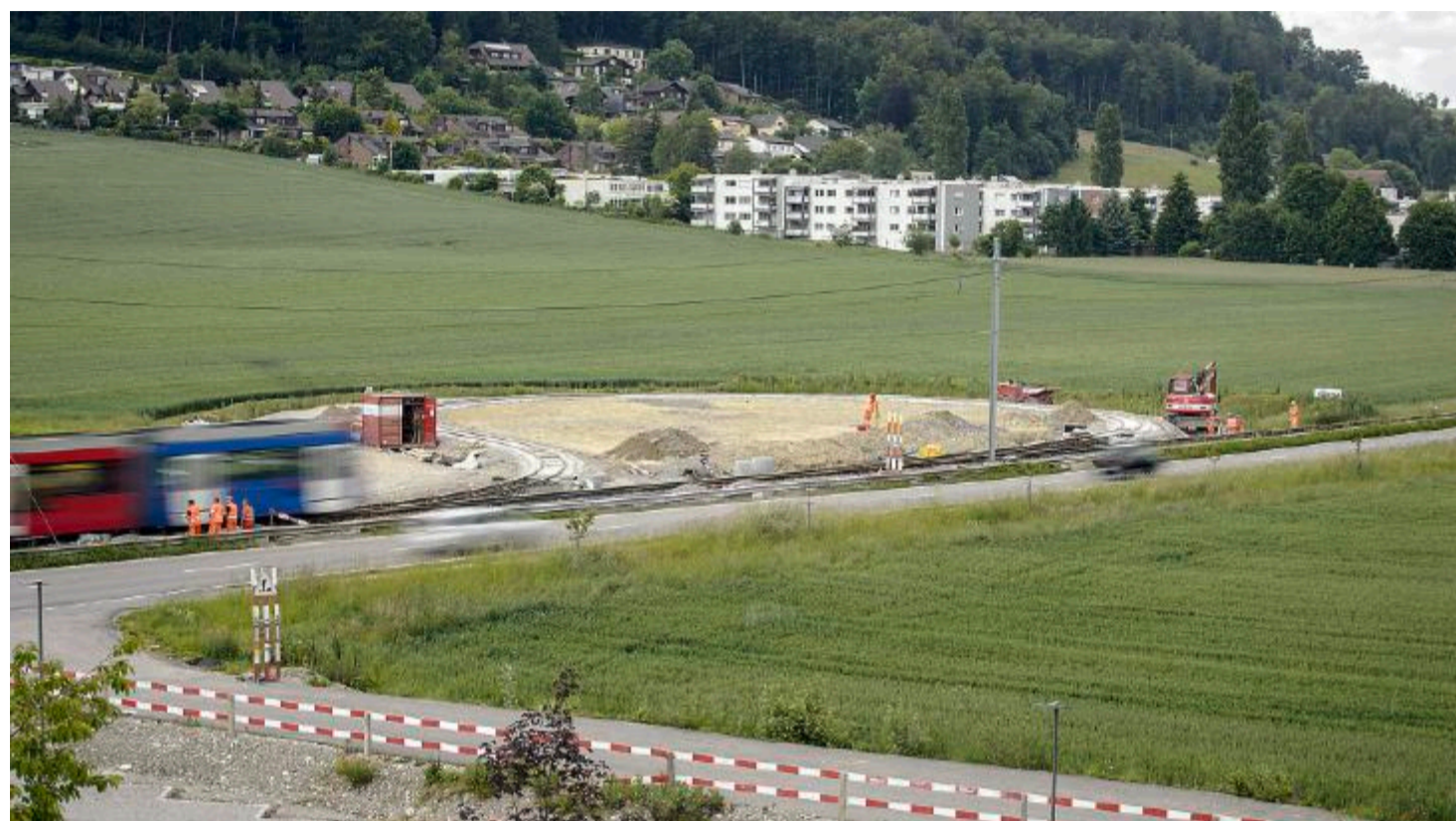
Die Tramwendeschleife beim Spital Siloah in Gümligen wird ins grüne Land hinein gebaut.
